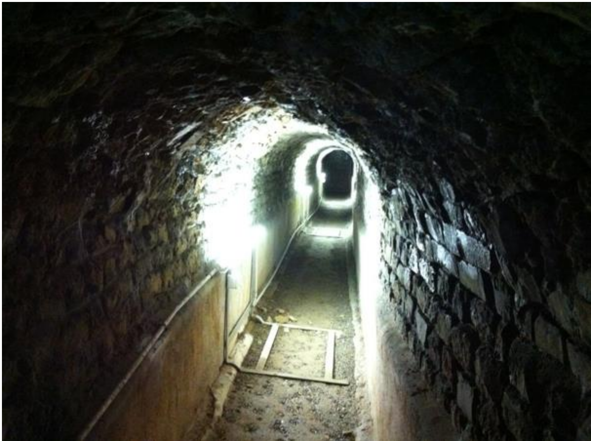
Abb. 1: Zugänglicher Abschnitt der römischen Wasserleitung nach Augusta Raurica am Zirkelirain in Liestal.
